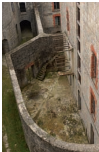
Dos de los muros derribados.
